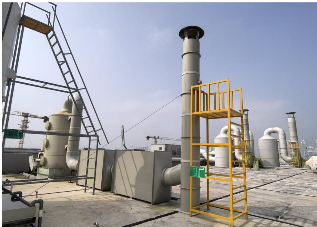
有机废气处理装置（喷淋除尘+活性炭吸附）
