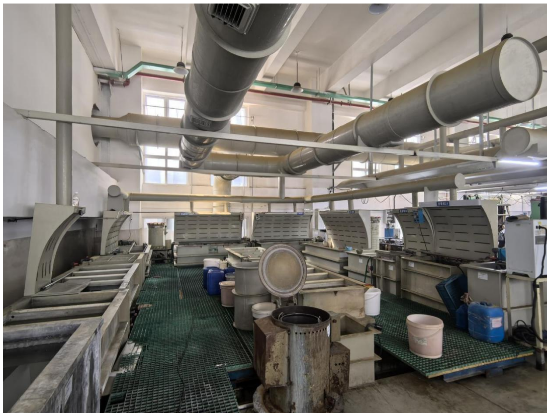
图4.1-3 废气治理装置及规范化排污口
