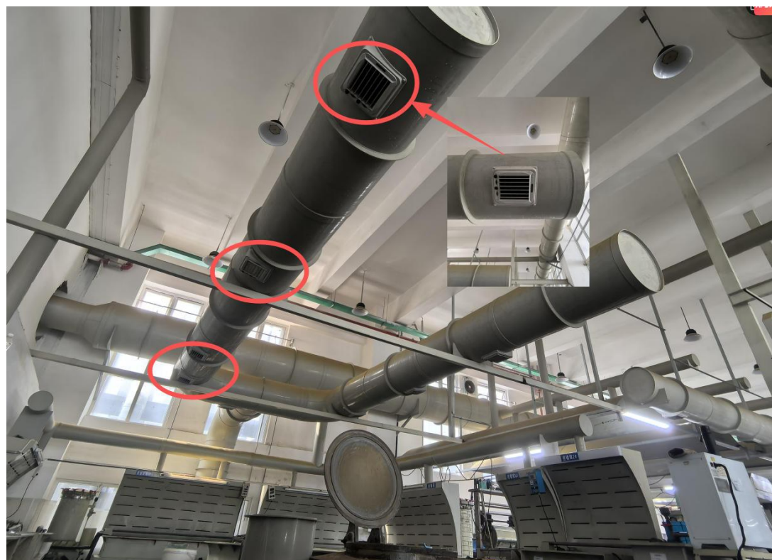
图4.1-4 生产现场酸雾废气收集装置
